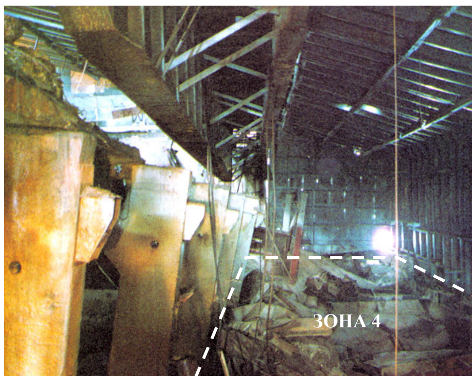
Рис. 7 Зона падения южных "клюшек" после разрушения балки "Осьминог"
